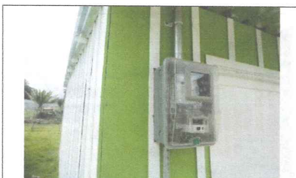
61. Medidor eléctrico funcionando
