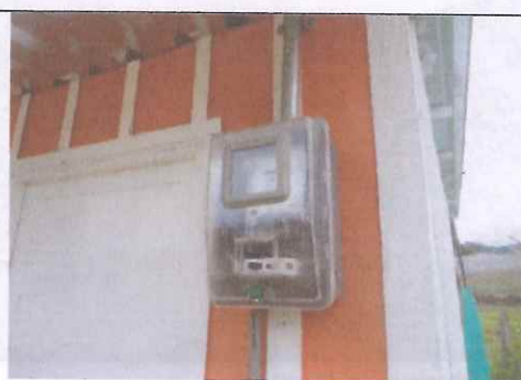
67. Medidor eléctrico instalado
