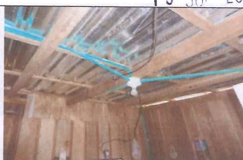
4. Puntos eléctricos, plafón
