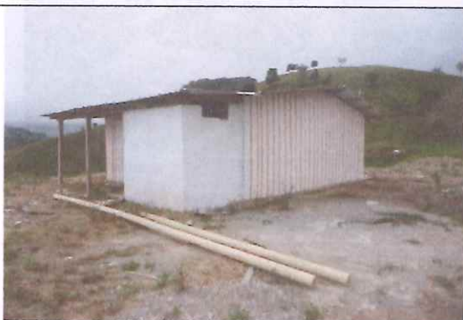
17. Instalaciones hidrosanitarias sin funcionar
