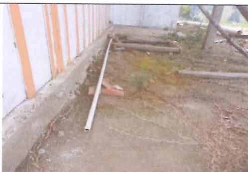
29. Acometida hidráulica sin completar
