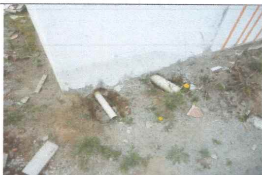
23. Descole sin funcionar, sin conexión
