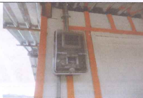
14. Medidor sin instalar, instalaciones eléctricas sin funcionar
