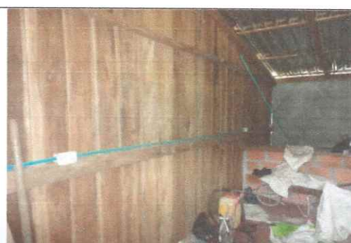
24. Puntos eléctricos que no funcionan
